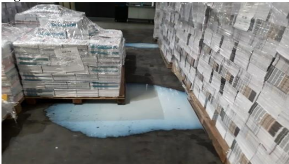
Figura 2 - Vazamento encontrado durante ronda de manutenção
