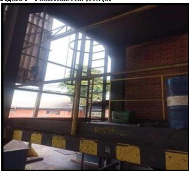
Figura 5 - Plataforma sem proteção
