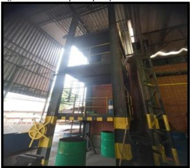
Figura 6 - Guarda corpo sem proteção
