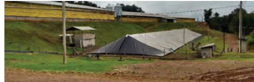
FOTO 04 | Sistema de captação da água da chuva, filtros e cisterna.
